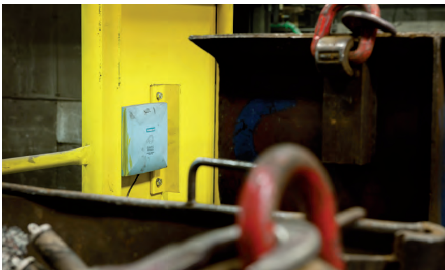
Bild 4: Wegen der beengten Platzverhältnisse auf der Ofenbühne kommt ein robuster RFID-Reader RF630R mit externer UHF-Antenne RF640A zum Einsatz, der zudem hohe Störfestigkeit in metallischen Umgebungen bietet
